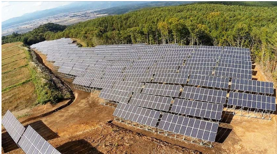
【画像 1-1】会津電力株式会社雄国太陽光発電所 （出典：会津電力株式会社HP）
